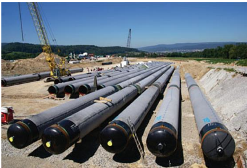
شکل ۴-۴: نمونه‌ای از تأسیسات ذخیره‌سازی لوله‌ای گاز
