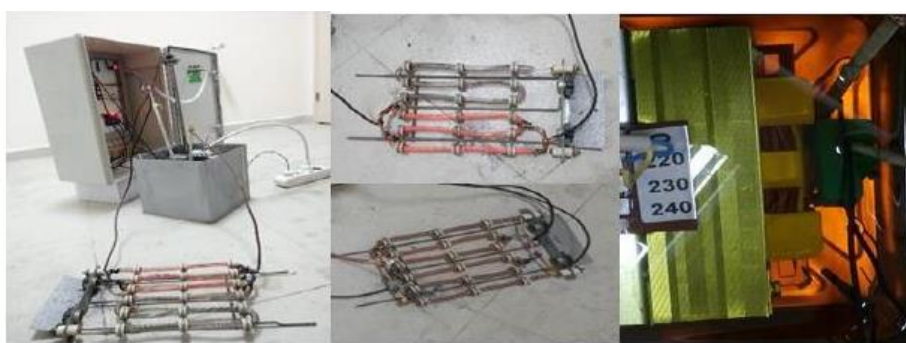
شکل ۷-۲۸: سیستم پایش ترانسفورماتور و تجهیزات تست
