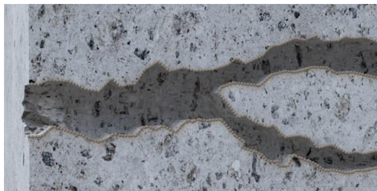
الف) نمایی از ترک در بتن
