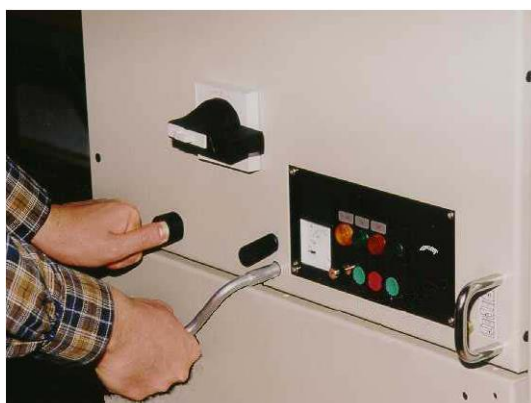
شکل ۱۹- تغییر وضعیت کلید به Disconnect
