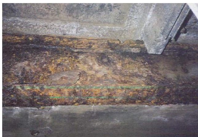
شکل ۱-۶۳ خوردگی تیر فولادی در سقف سازه
