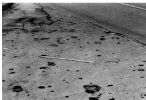
شکل ۲-۳۵ بیرون پریدگی روسازی بتنی
