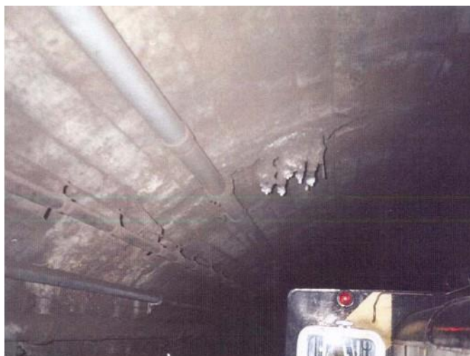
شکل ۴۳→ ریزش سقف تونل به دلیل نشت آب
