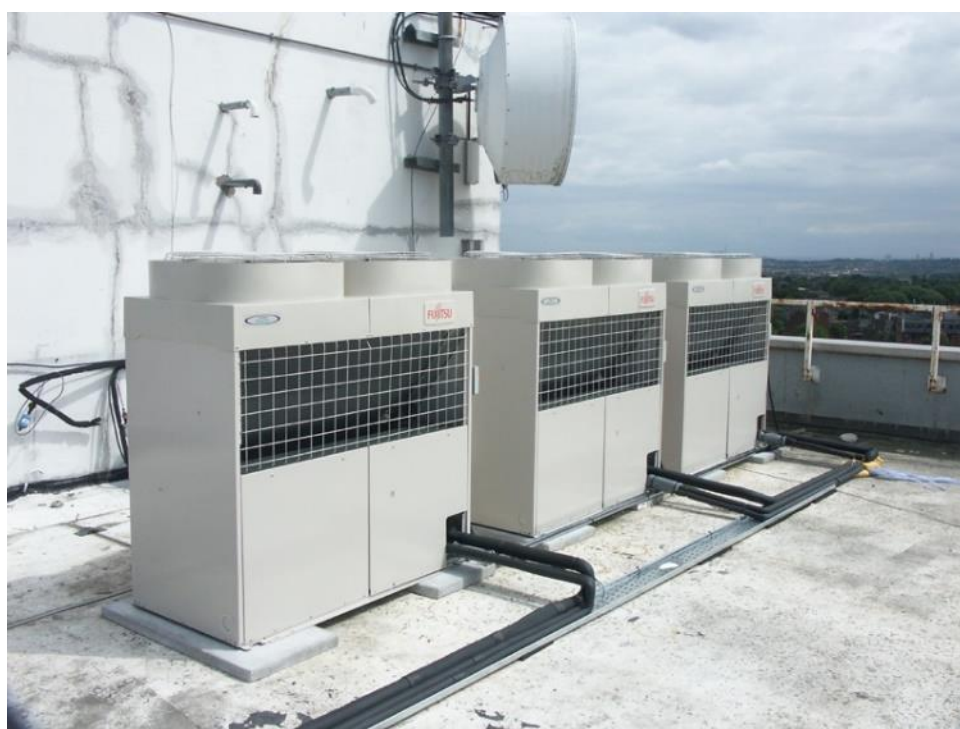
شکل ۴-۱ نمای کندانسینگ یونیت خارجی سیستم VRF
