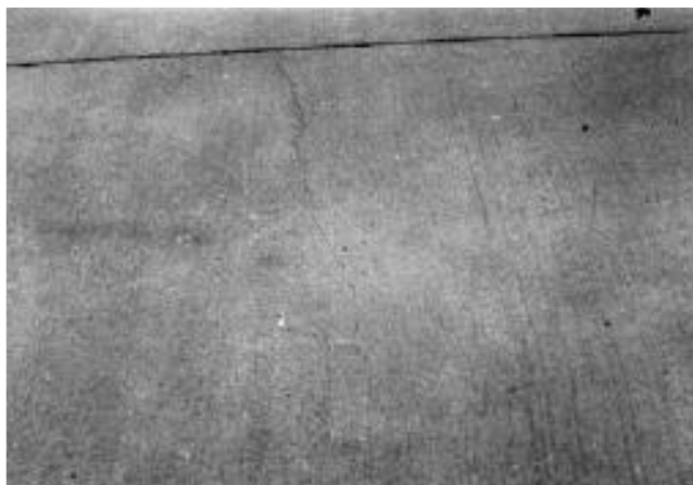
شکل ۲-۳۷ خرابی ترک‌خوردگی انقباضی
