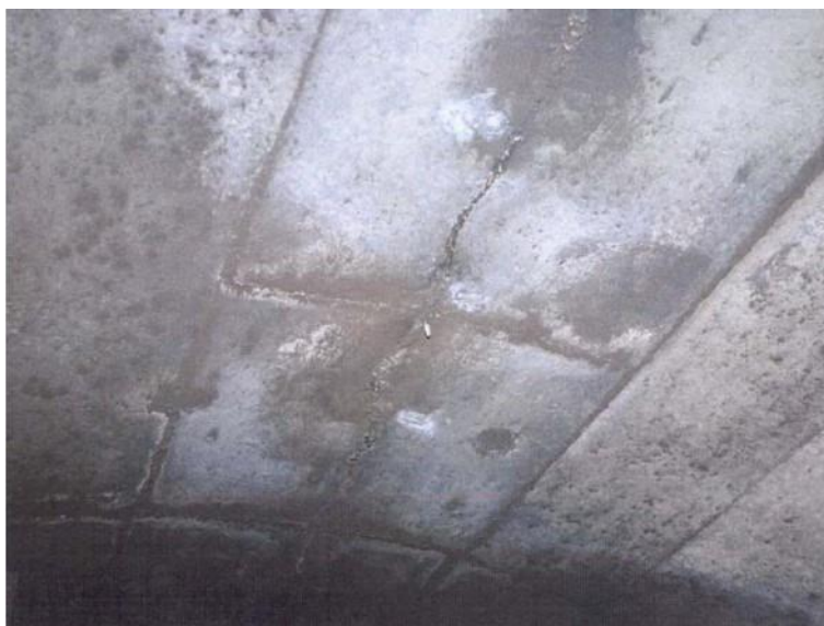
شکل ۳۷-۴ وقوع پدید ترک خوردگی در سقف تونل
