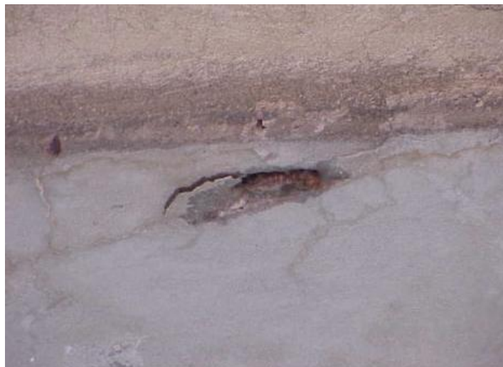
شکل ۴۰-۴ پدیده قلوه‌کن شدن بتن
