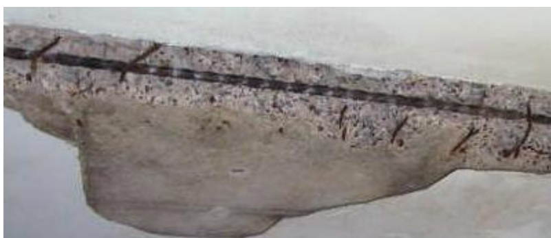
شکل ۳۹- ریزش بتن در اثر پدیده پوسته‌شدگی
